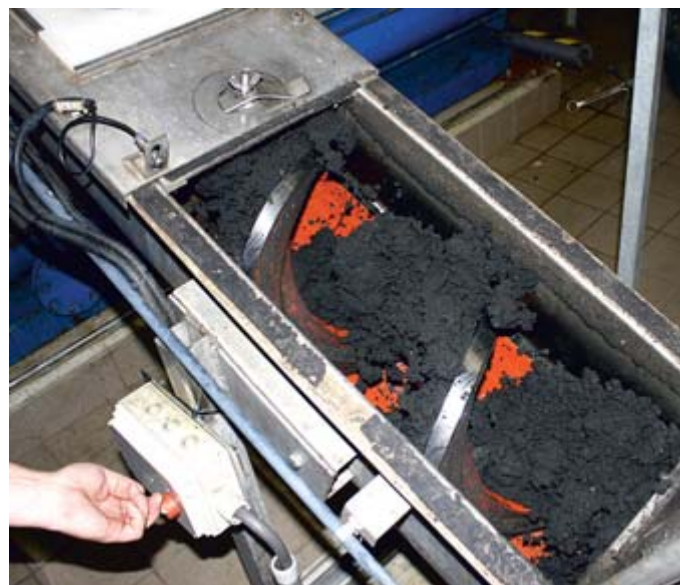
Det avvattnade slammets transporteras via en skruv till lagringstornet (Lundåkraverket).
